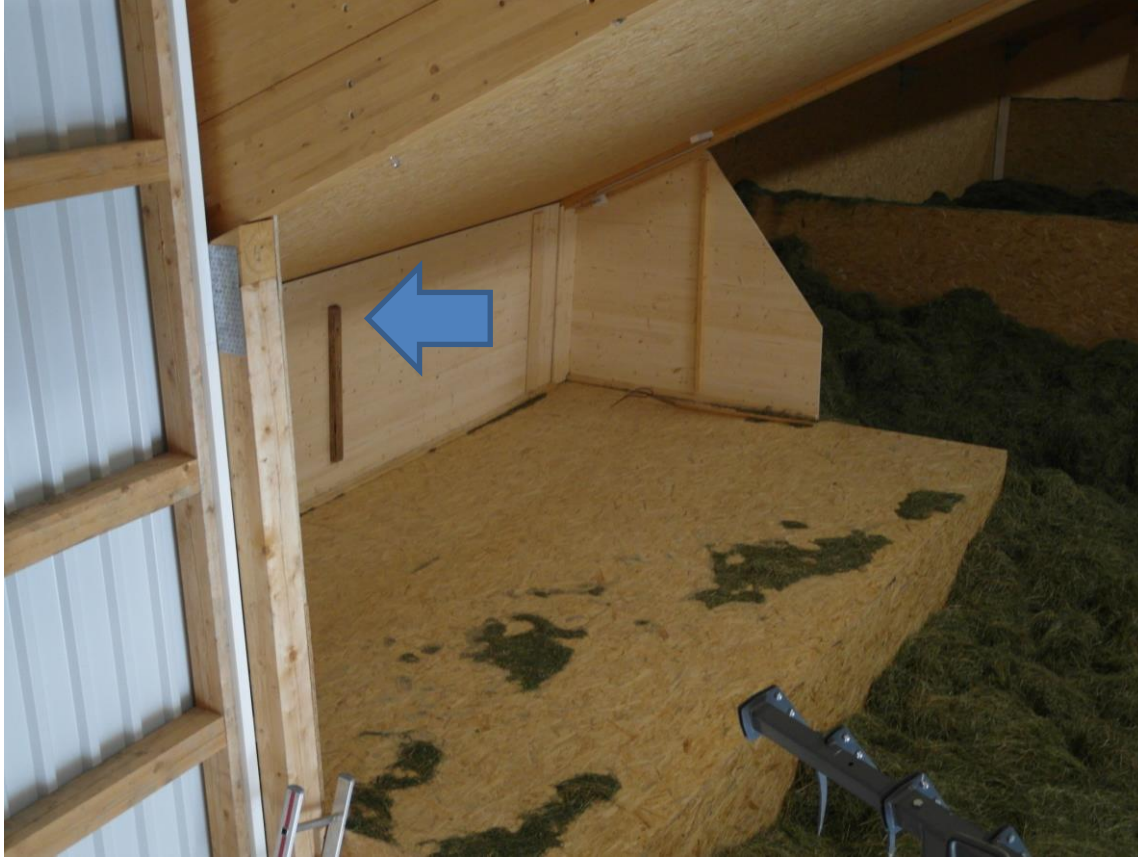
Umschaltklappe über Lüfterkammer
